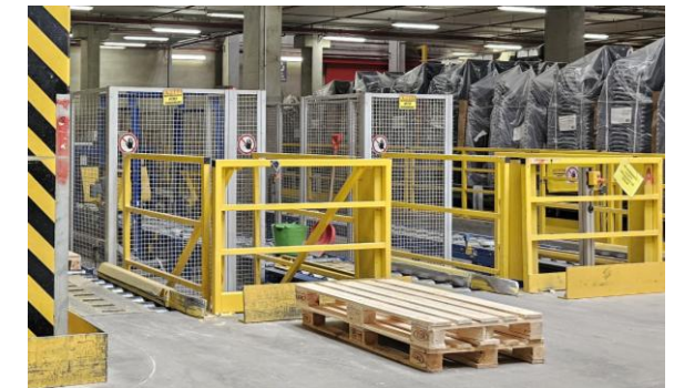
Automatyczne stacje kontroli palet
